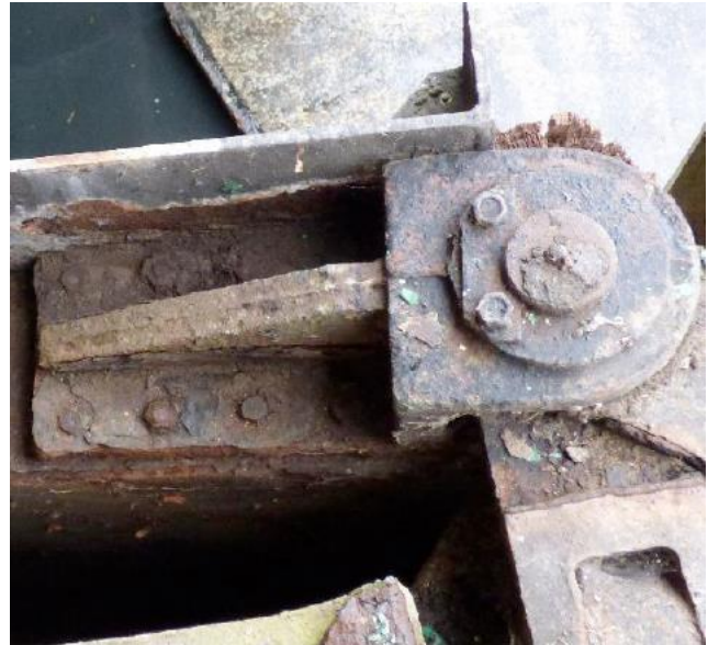
Abbildung 18: Korrodierte Halslager der Fluttore
