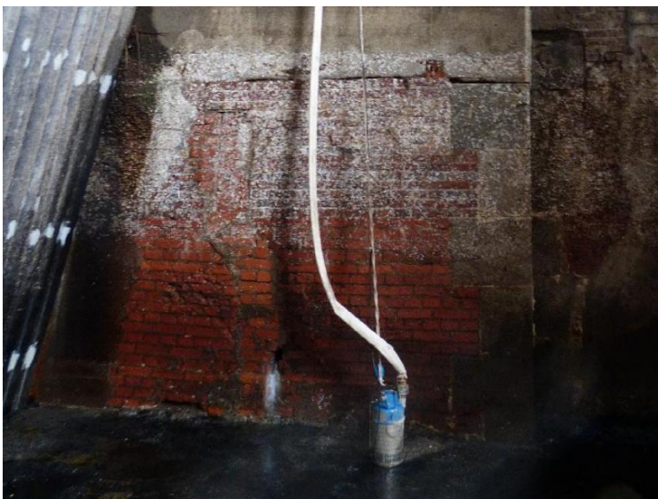
Abbildung 16: Mauerwerk im Unterhaupt mit wasserführendem Riss
